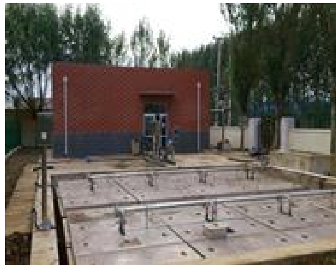
全地下式。マンション横手。 建屋内に各種機器設置。
