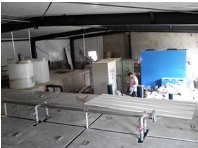
半地下式。右手奥青色は脱臭装置。
